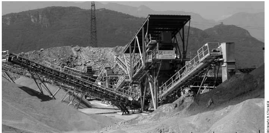
Il deposito dei materiali di scavo dei tunnel di Ora e Laives
